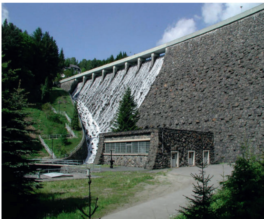
Im Hochwasserfall fließt das Wasser über den Überfall die Schussrinne entlang ins Tosbecken und wird so direkt an den Saidenbach hinter der Talsperre abgegeben.
