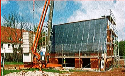
ENERGETIKhaus100®basis im Solar Areal Rittergut Rabenstein
