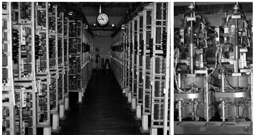
Blick in eine Wählvermittlungsstelle (Wählersaal), mit Detailansicht von Hebdrehwählern
